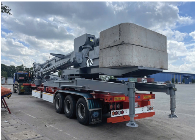
03 Dự án triển khai xe bơm bê tông tầm xa phục vụ thi công nền móng tại Cần Thơ
