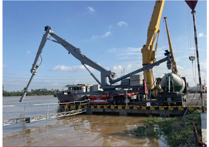
02 Dự án thi công bơm bê tông tại khu vực bến thủy tại Kiên Giang
